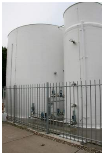
HYDROLYSE EN VERGISTER
